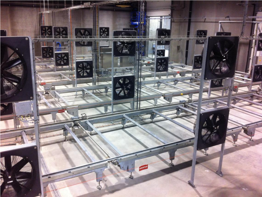
Unikt ventilationssystem - i loftet er monteret bestøvere, som sammen med ventilatorerne sørger for afkøling af kyllingerne om sommeren
