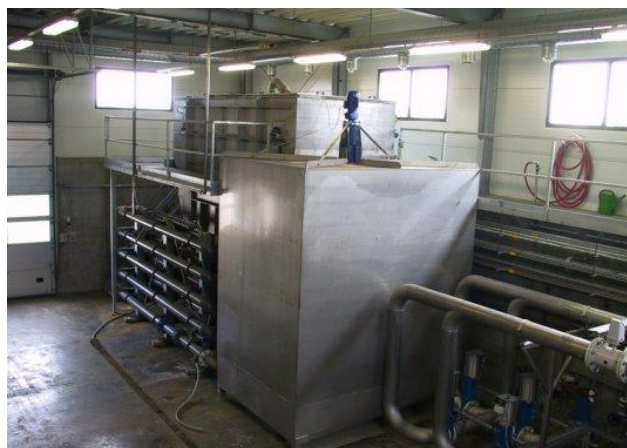
Rørflokkulator og flotationsanlæg
